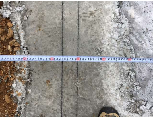
建物北西 墨打ち追い出し確認②
